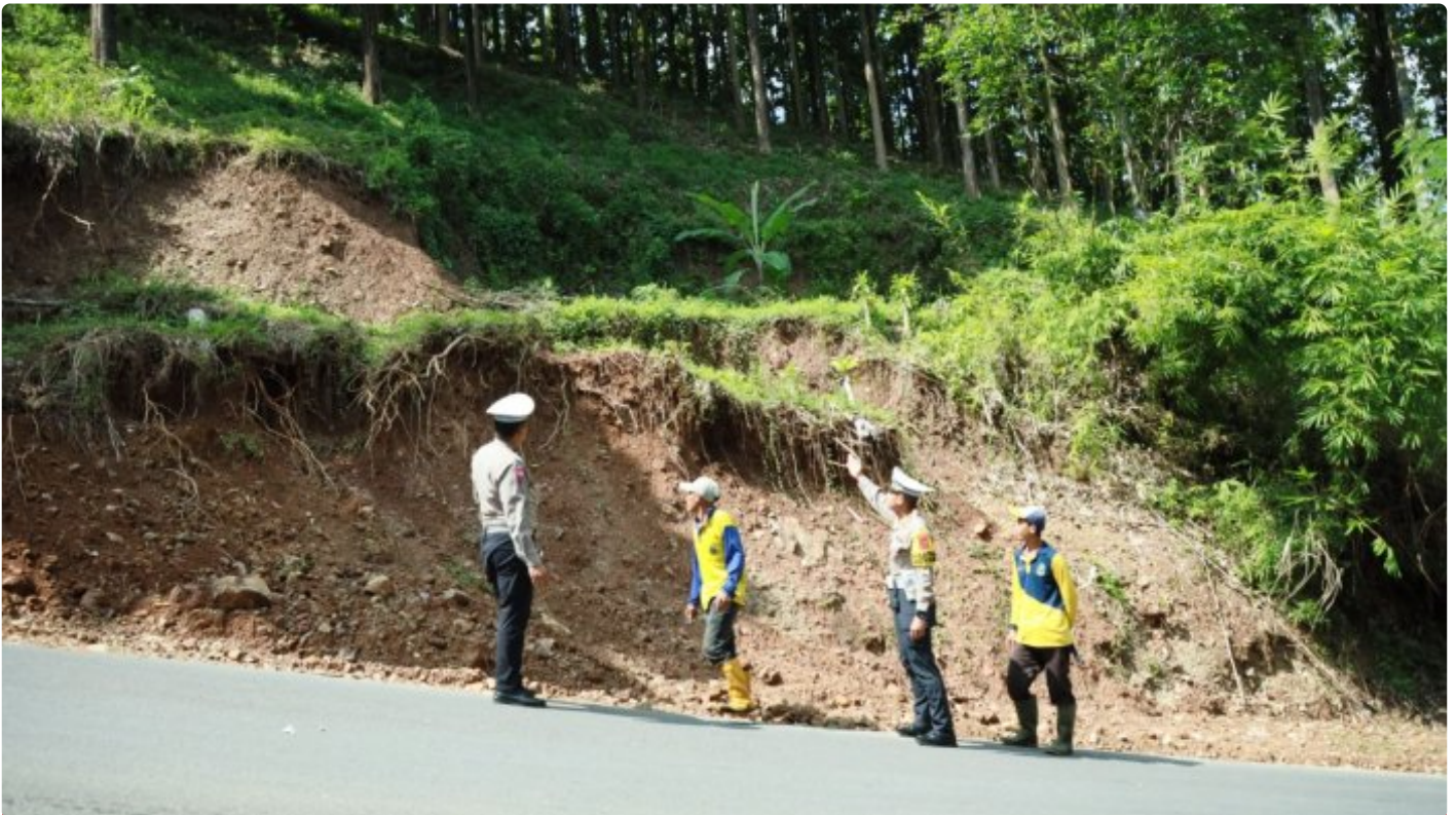
Survei Tanah Longsor di Cikidang Sukabumi, Acp Fiekry Himbau agar Pengendara selalu Waspada
